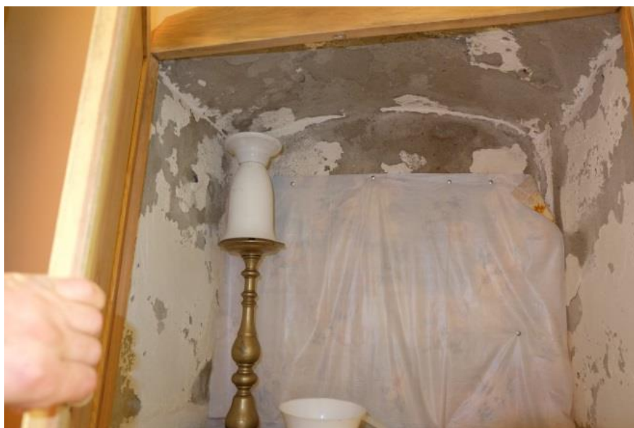
Rys. 11. Ściana w zakrystii – zawilgocona wnąka .
