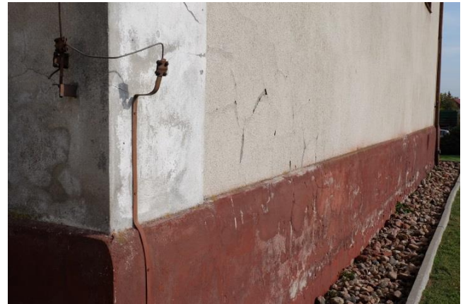
Rys. 6. Zawilgocona ściana południowo – zachodnia
