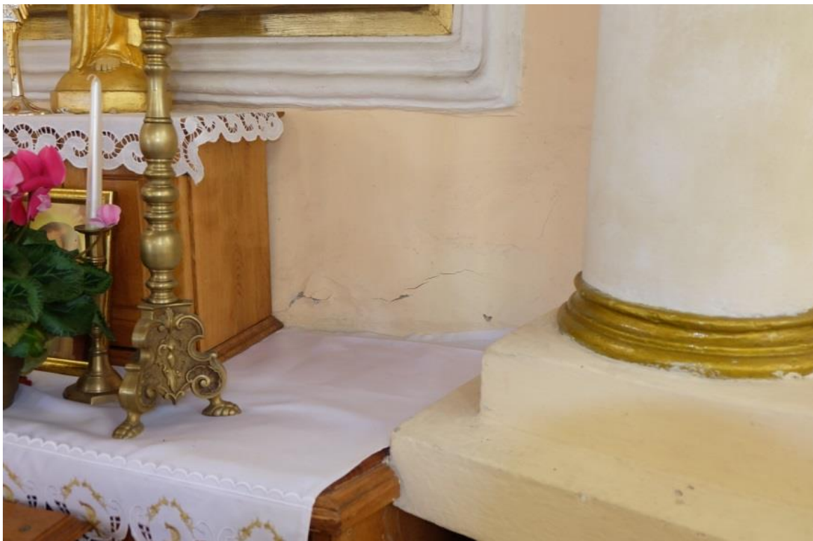
Rys. 9. Ściana wewnętrzna- pęknięcia tynku, ściana zawilgocona.
