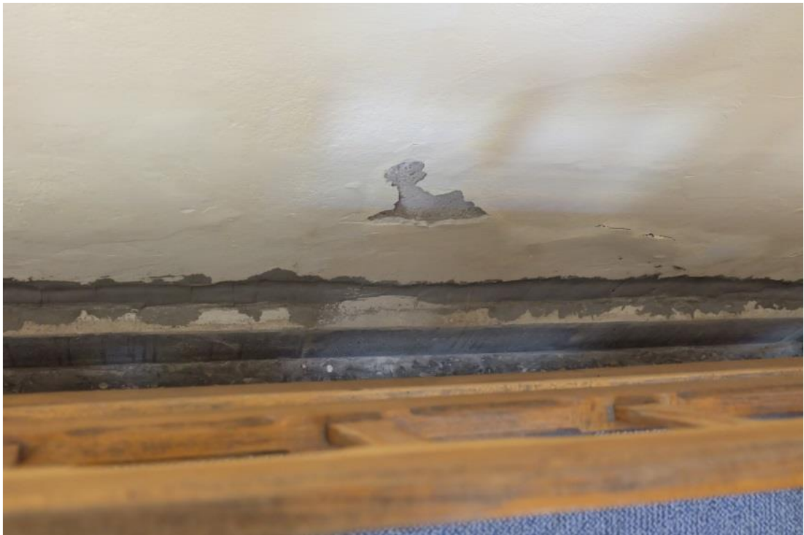
Rys. 8. Powierzchnia wewnętrzna ściany - ubytki tynku, ściana zawilgocona.
