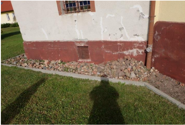
Rys.5. Zawilgocona ściana zewnętrzna zakrystii.
