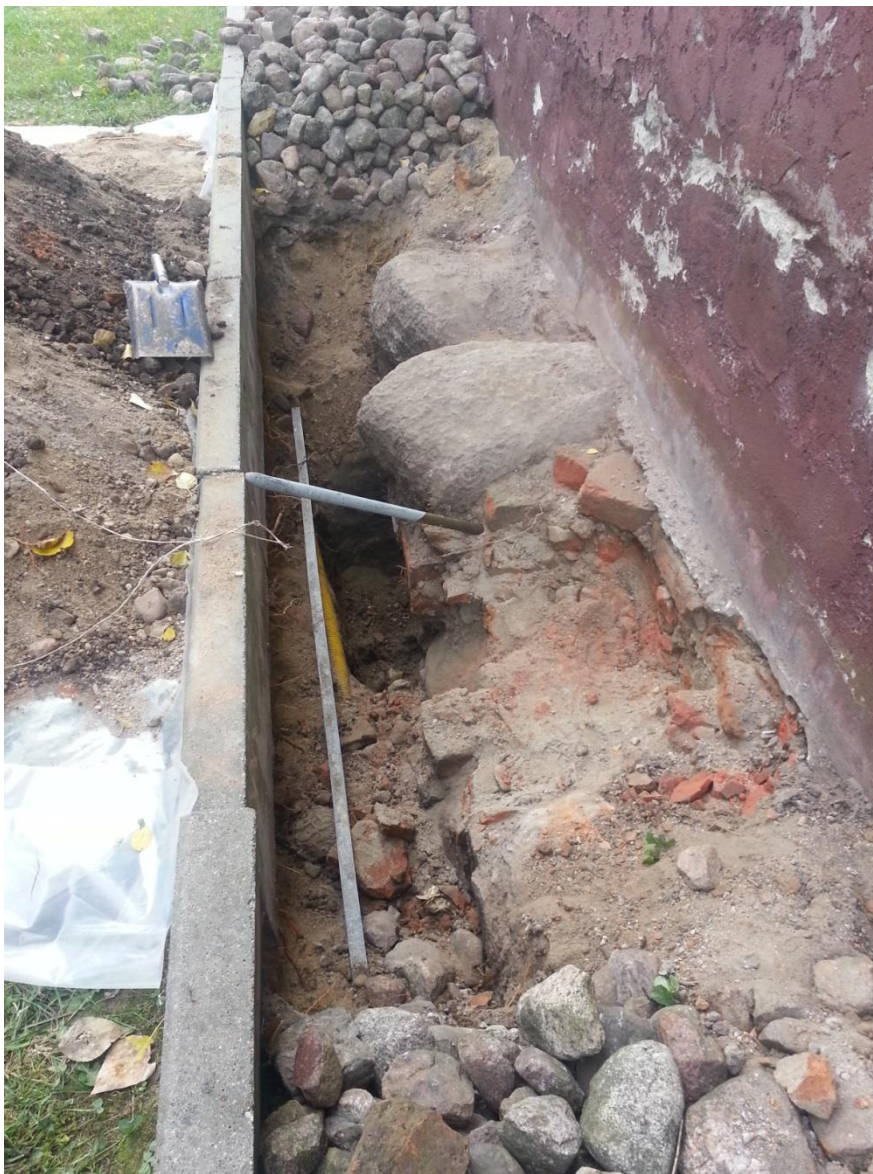
Rys. 7. Widok odkrytego fundament – brak izolacji pionowej i poziomej.
