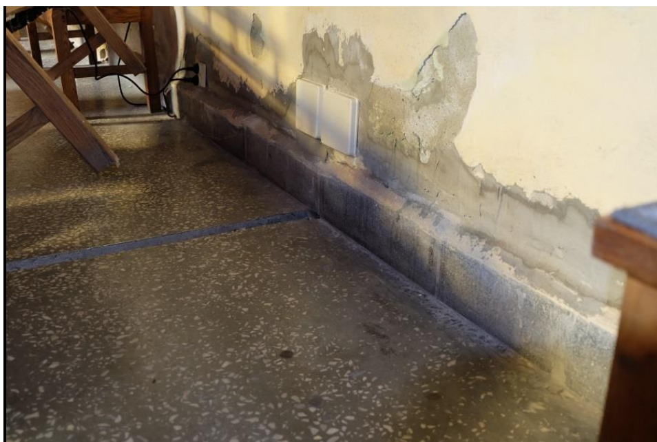
Rys. 10. Powierzchnia wewnętrzna ściany - ubytki tynku, ściana zawilgocona.
